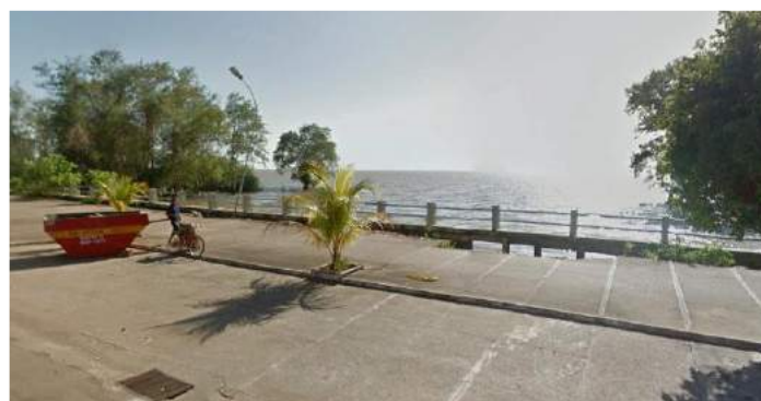
Figura 1. Patologia no muro de contenção em 2012 – bairro do Perpétuo Socorro.
