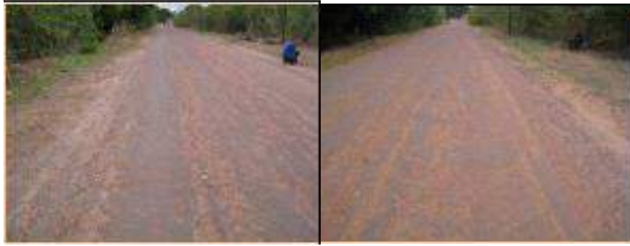
Figura 10. Estado da camada de base com solo-emulsão, após 20 meses de execução (Sant'Ana, 2009).
