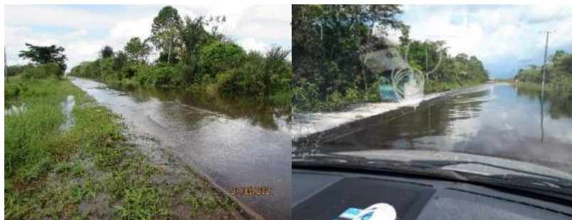
Figura 21. Cheia dos rios provocando galgamento em alguns pontos da rodovia BR-319 (Fotos: N.S. Campelo).
