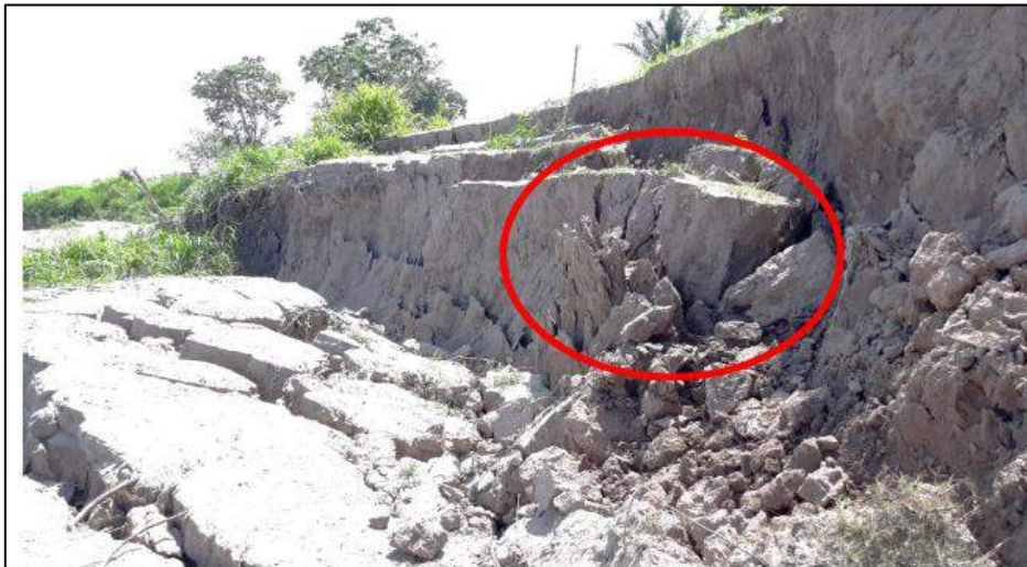
Figura 12. Visão do bloco desmoronado por dentro
