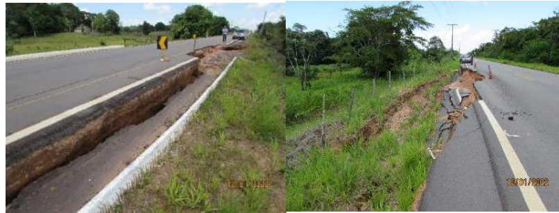
Figura 23. Ruptura de taludes rodoviários, após ciclo de vazante dos rios (Fotos: N.S. Campelo).
