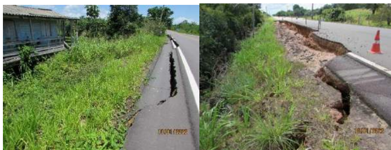
Figura 22. Ruptura de taludes rodoviários, após ciclo de vazante dos rios (Fotos: N.S. Campelo).
