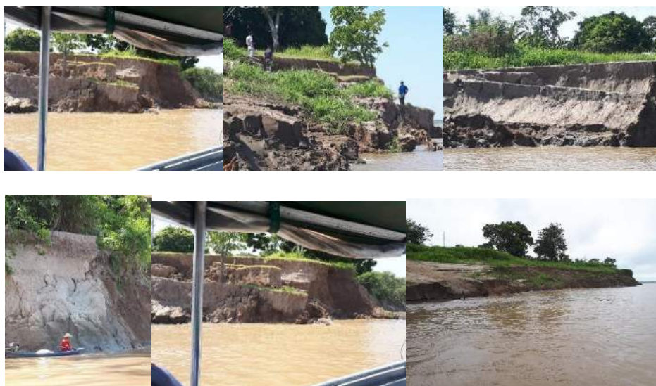
Figura 24. Fenômeno das “terras caídas” em região do Careiro da Várzea, em frente à cidade de Manaus (Fotos: N.S. Campelo).
