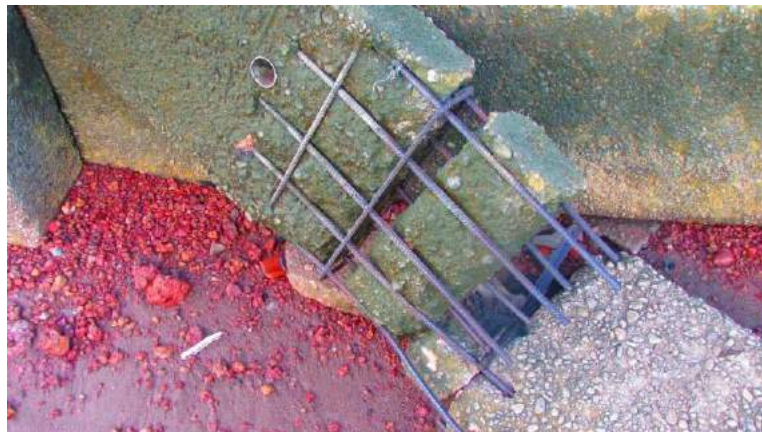
Figura 4. Patologias em uma das placas pré-moldadas.
